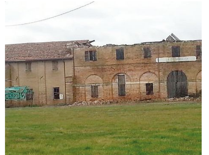
Il tetto di un vecchio edificio crollato a San Gaetano
