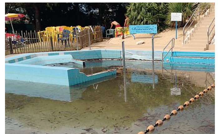
Danni all'Aquafolie e sopra via Santa Margherita dopo la grandinata
