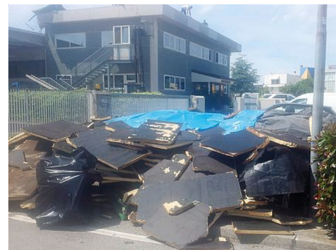
Il tetto distrutto della falegnameria
