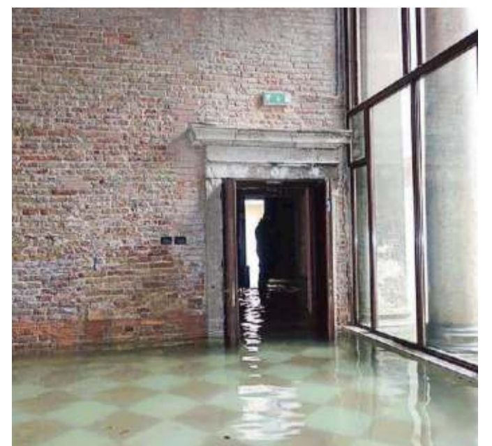
La sede Iuav di Ca' Tron chiusa per i danni dell'acqua alta
