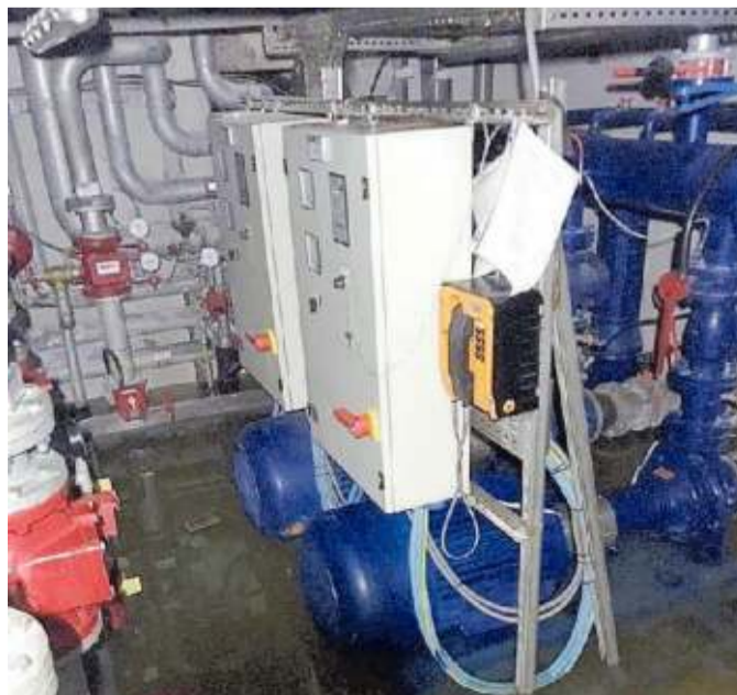
La sala degli impianti elettrici della Fenice sommersa dall'acqua
