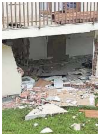
La palazzina esplosa
