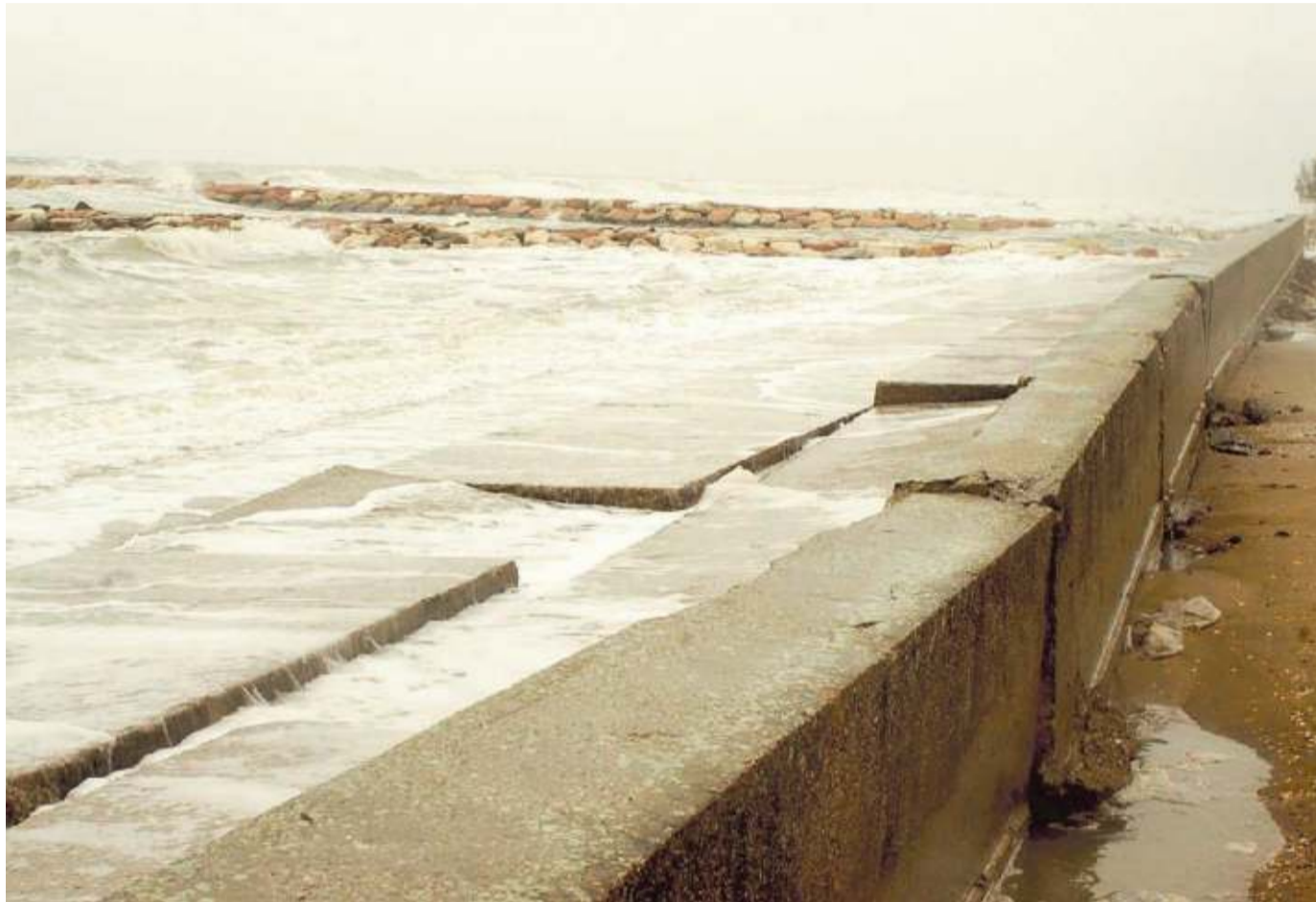
I danni provocati ieri mattina dalla mareggiata alle protezioni in cemento della spiaggia ad Eraclea
