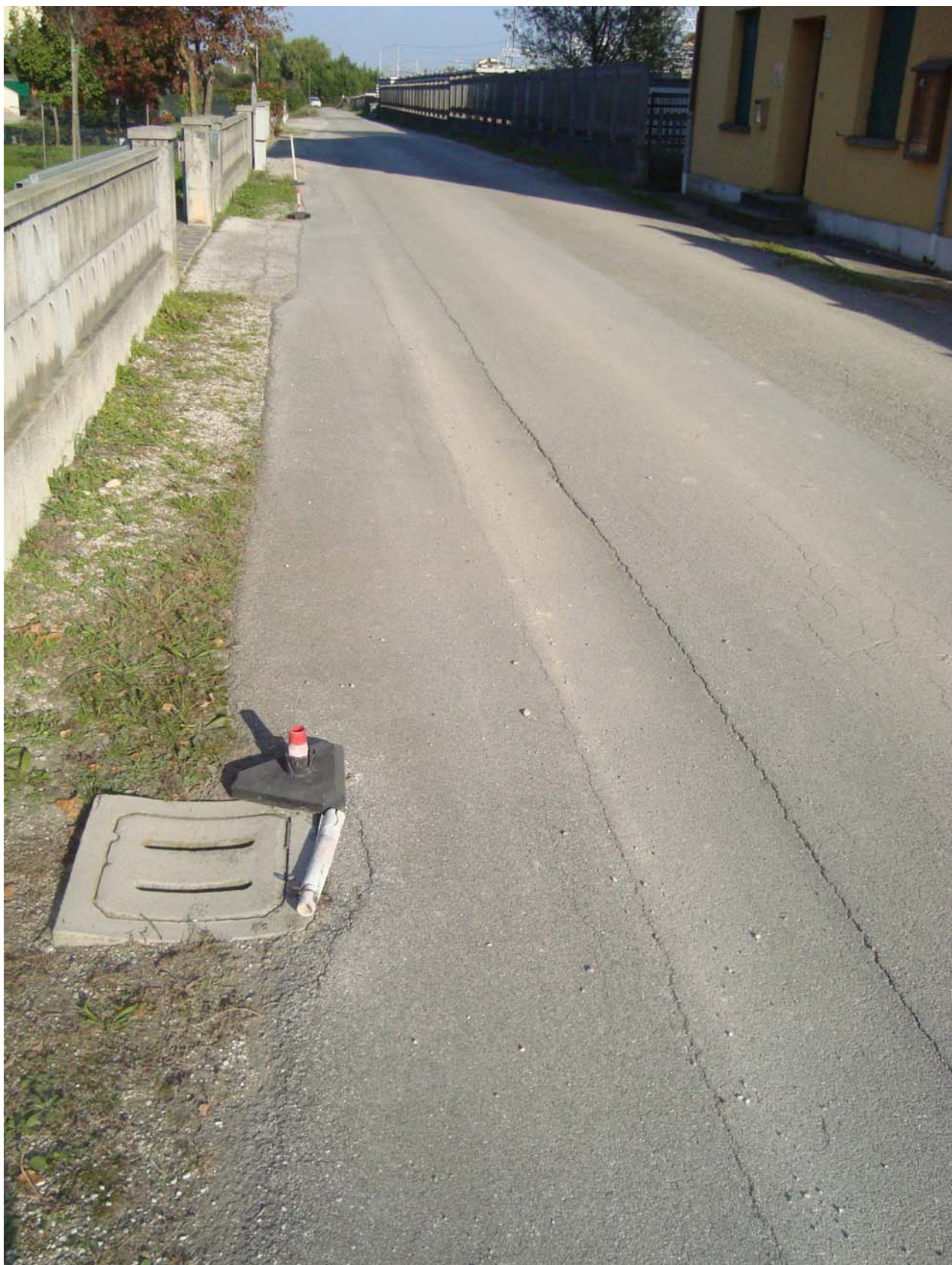
PORTOGRUARO - CANTIERE ADIACENTE VIA NOBILE - OTTOBRE 2014 ECCO LE CONDIZIONI DEL MANTO STRADALE SOTTO "STRESS"
