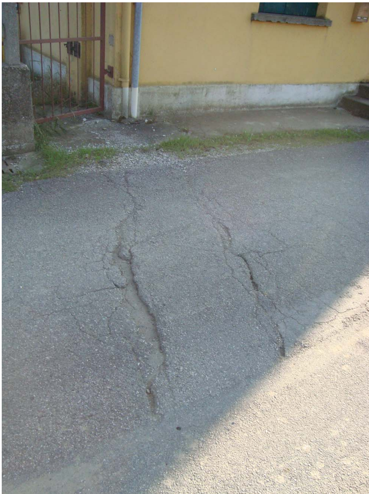
PORTOGRUARO - CANTIERE ADIACENTE VIA NOBILE - OTTOBRE 2014 ECCO LE CONDIZIONI DEL MANTO STRADALE SOTTO "STRESS"
