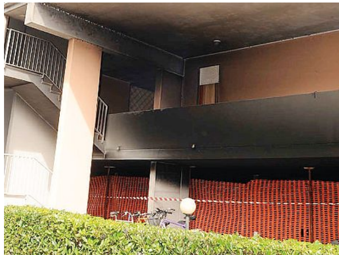
I danni prodotti dal rogo a una parte del condominio (foto Dino Tommasella)
