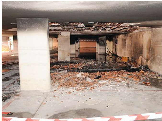
L'interno del garage del condominio Cormor dopo il furioso incendio
