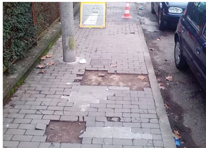
Il marciapiede in via Dante completamente distrutto
