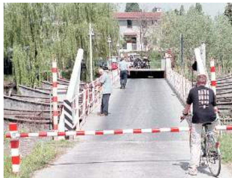
LAVORI IN CORSO Da domani sul ponte di Caposile per dieci giorni non si potrà transitare dalle 8 alle 12.30 e dalle 13.40 alle 18
