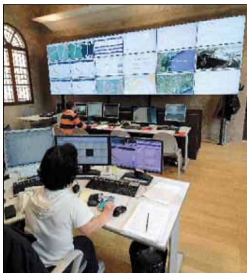
VENEZIA La sala controllo del sistema Mose
